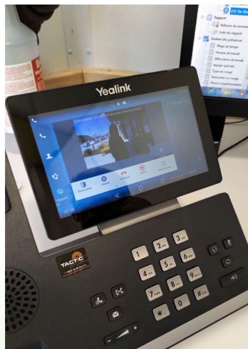
La téléphonie IP est un des deux systèmes qui assure le bon fonctionnement du contrôle d'accès des portes à distance.
